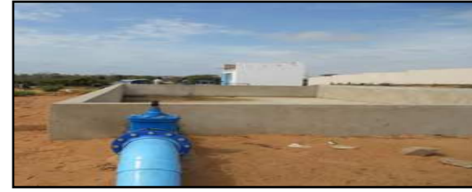
Infrastructures permettant le transport et la distribution de l'eau usée traitée
