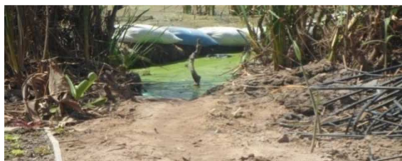
Photo 4: Digue de sacs de sables
