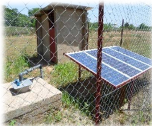
Photo 5 : Système de pompage par énergie solaire à Kafigué Source : ANADER (2016)
