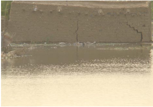
Une habitation en banco s'affaisse sous l'emprise des eaux
