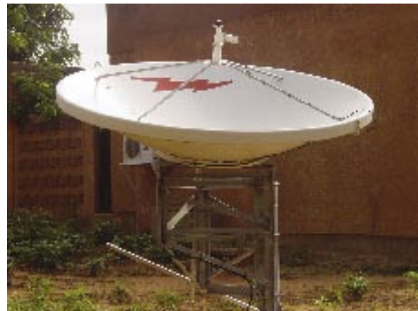
Antenne de réception du satellite MSG
